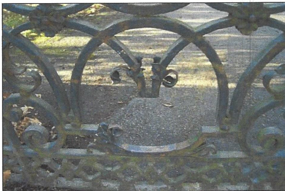
Fot.14 Widoczny brak elementów dekoracyjnych kwatery dolnej zachodniej.
