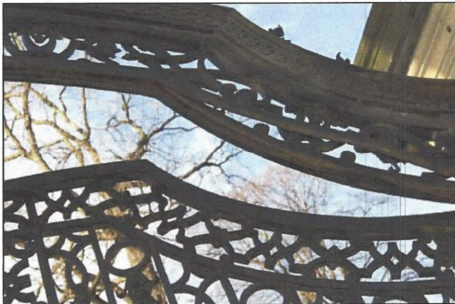
Fot.12 Stan przed konserwacją. Widoczne uszkodzenia metalowej listwy obramienia.
