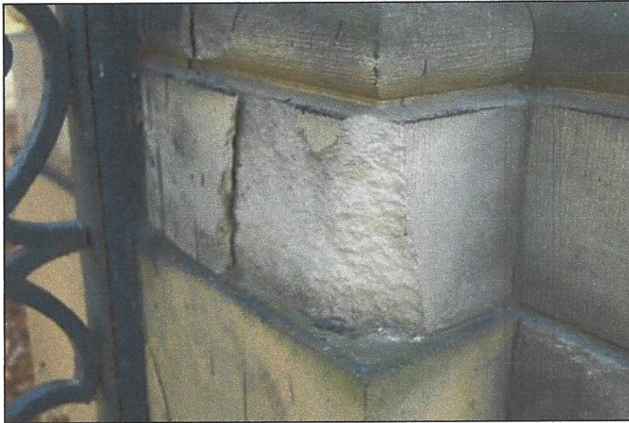
Fot.9 Stan uszkodzeń. Ujęcie filara ośmiobocznego zachodniego.
