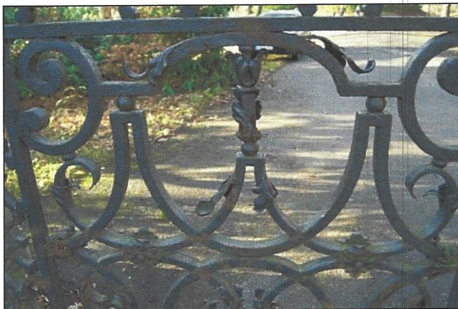
Fot.13 Stan zachowania dolnej kwatery skrzydła zachodniego.
