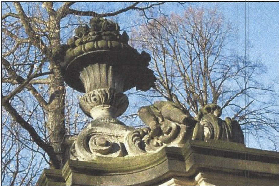
Fot.6 Stan przed konserwacją. Putto z brakującym tułowiem i lewą stopą.
